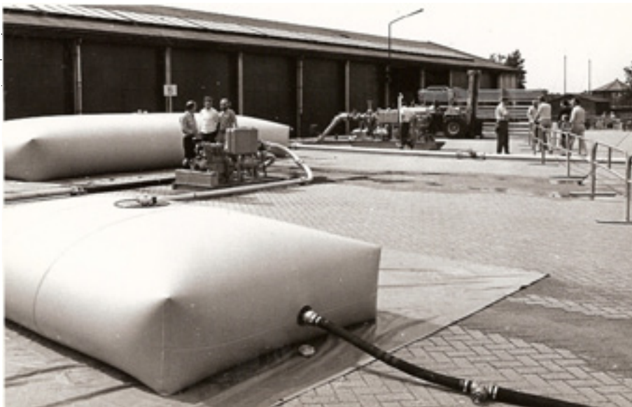
AFBEELDING 02 NOODDRINKWATER- RINGSINSTALLATIE (GR)
